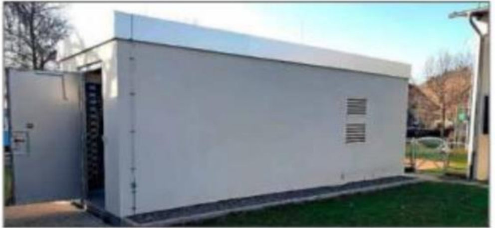
Der „POP“ („Point of Presence“) in Buchholz. Foto: Stadtwerke Waldkirch
