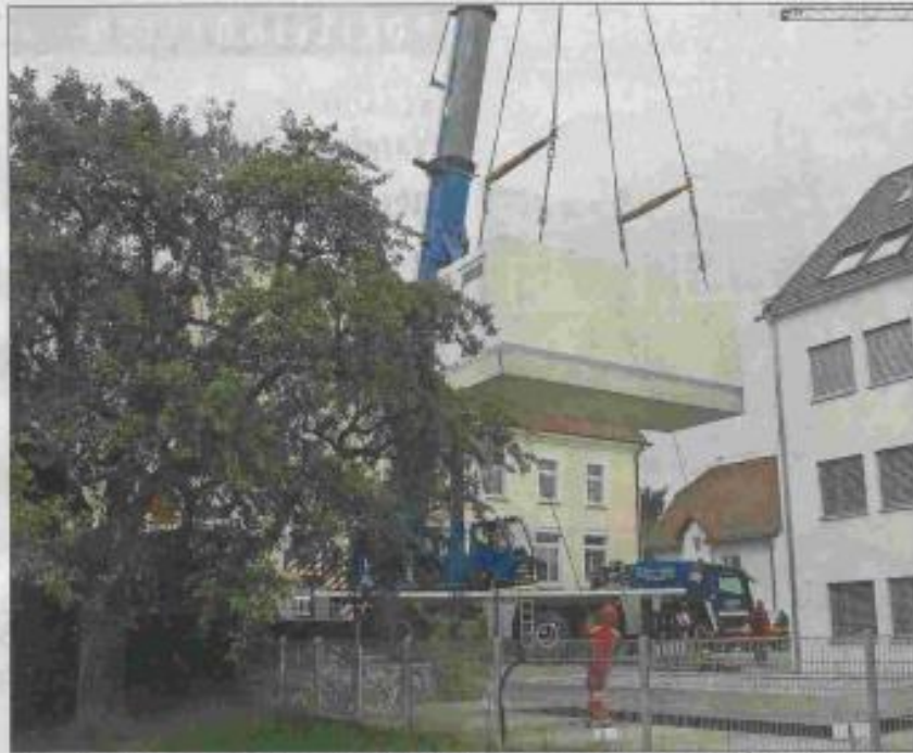
Die Glasfaser-Verkabelung in Waldkirch-Buchholz kommt voran. Auch das notwendige Servergebäude wurde bereits angeliefert.
