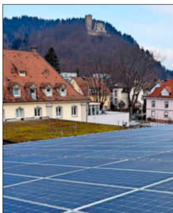
Neue Photovoltaik-Anlage der Stadtwerke auf der Stadthalle mit leichten GFK-Modulen FOTO: SWW
